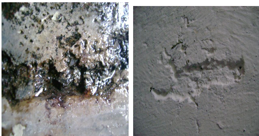
Figura 2- Presencia de hongos en el sustrato, producto de la alta humedad, se muestra detalles antes y después de la aplicación del producto.
