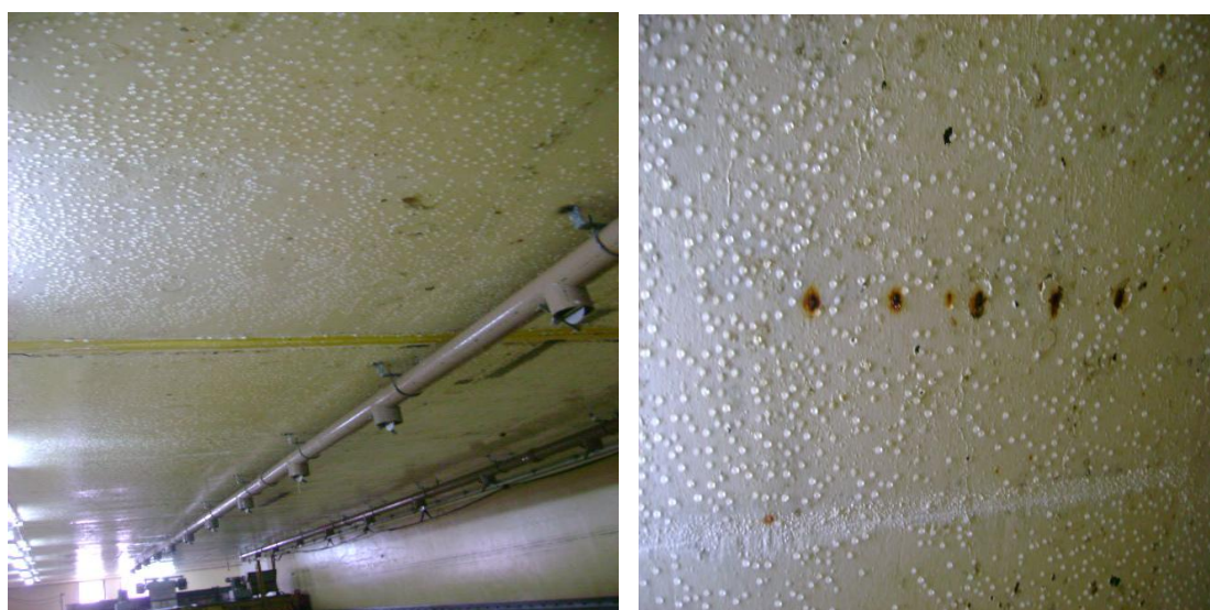
Figura 1- Condensación permanente en el sustrato, producto de la alta humedad propia del proceso.
